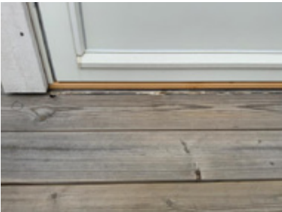
Mangler beslag under dør
