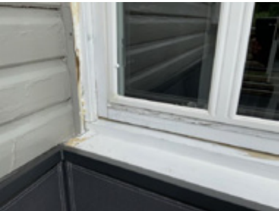
Slitt vindu i entré
