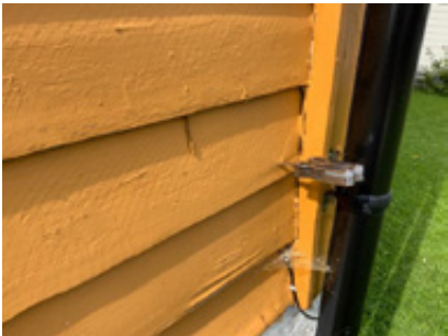
Råte i kledning
