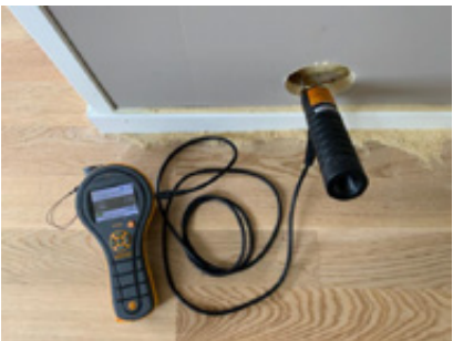
Fuktundersøkelse i vegg
