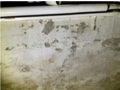
Saltutslag på kjeller vegger
