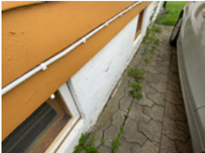
Bom og sprekker i murpuss
