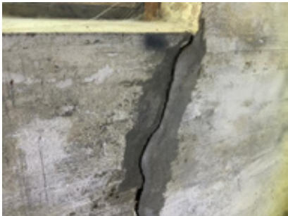
Sprekker i grunnmur
