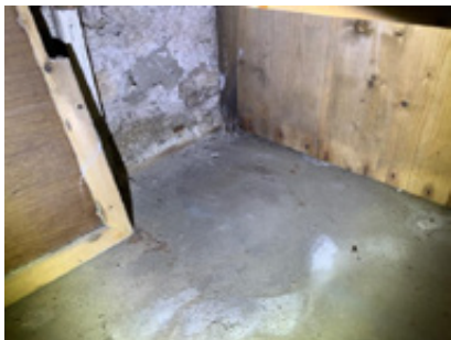
Påbegynnende råde i treverk
