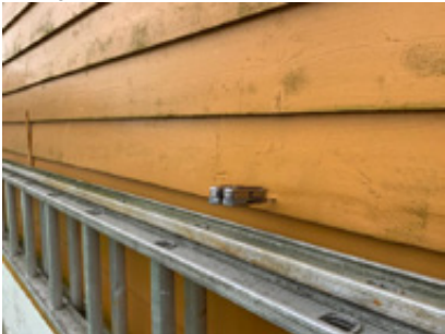
Råte i kledning
