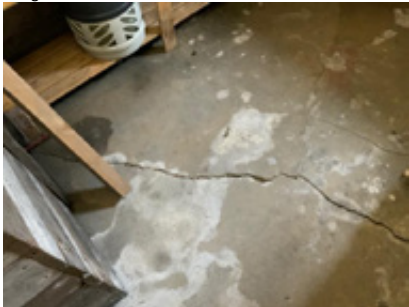
Sprekker i betongulv
