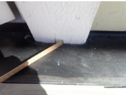
List/omramming på terrassedør er ført helt ned til beslag.
