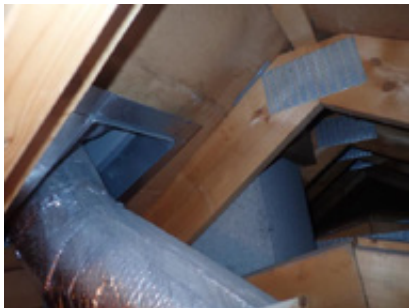
Skjolder i undertaket rundt takhatt.
