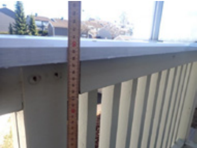
Rekkverk under 1 meter
