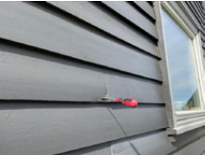
Påbegynnende råte i kledning
