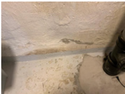
Saltutslag på vegg i kjellerbod
