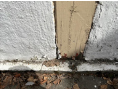
Blødt treverk ned mot terreng
