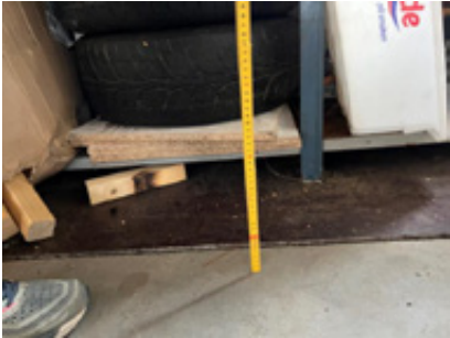
Feil fall på garasjegulv
