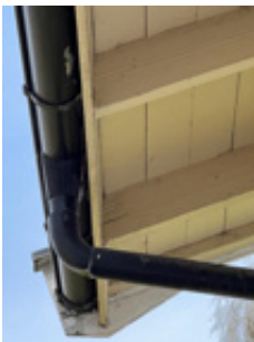
Påbegynne råte i takstoler vest
