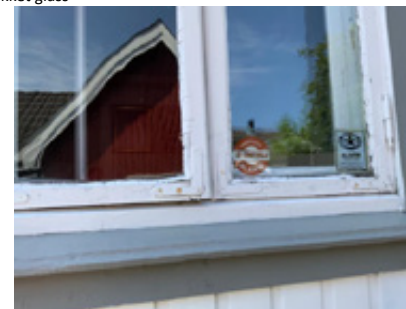
Slitte vinduer med råte
