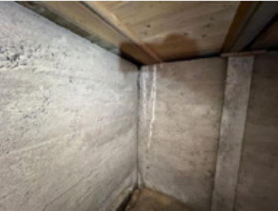
Sprekker i hjørner kjellervegg
