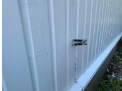
Påbegynnende råte i kledning
