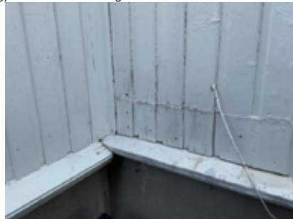
Påbegynnende råte i kledning
