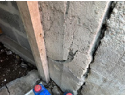
Sprekker ved kjellertrapp
