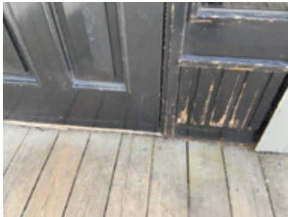
Slitt og utett inngangsdør
