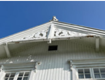
Råte i utvendig takkonstruksjon
