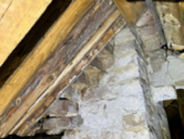
Fuktmerker i undertak
