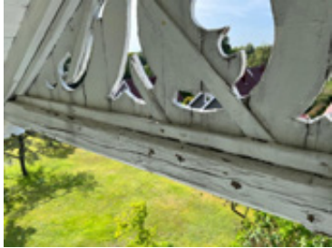
Råte i utvendig takkonstruksjon
