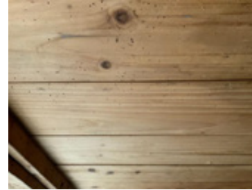
Merke etter borebiller i kjellerhimling
