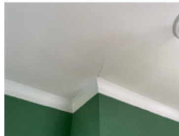
Skader i trukne tak soverom
