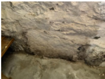
Saltutslag i kjellervegger
