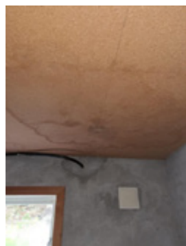
Fuktmerker i himlinga i vaskerommet.
