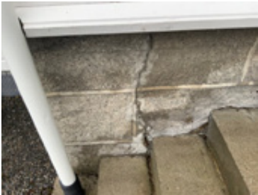
Sprekk i sydøst hjørne
