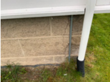
Sprekk i sydvest hjørne
