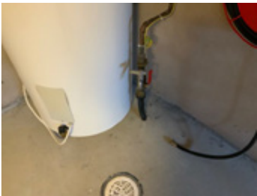
Stoppekran i kjeller
