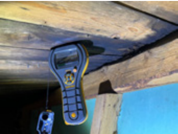
Fuktmerker i undertak
