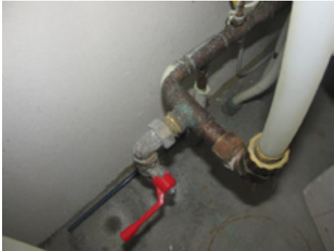
Stoppekran på vassinntaket.
