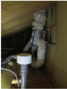
Avtrekksvifta er montert i loftskott.
