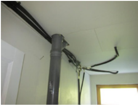
Avløpsrør med stakeluke.
