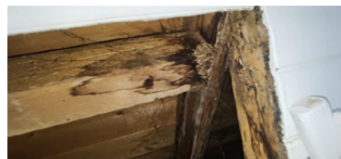
Missfarga del av innvendig tak, synleg frå kaldloft
