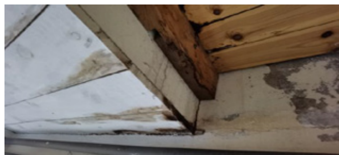
Roteskada himling/etasjeskille i kjeller
