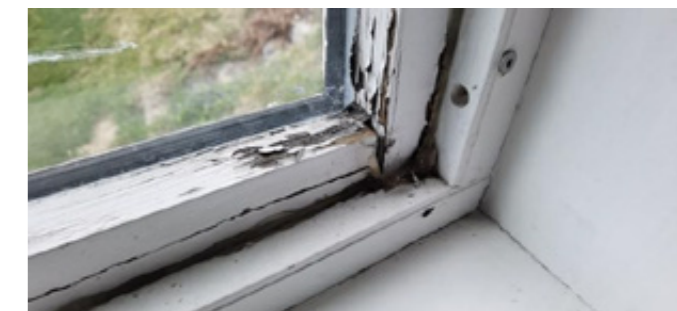
Skada innvendig vindaugskarm
