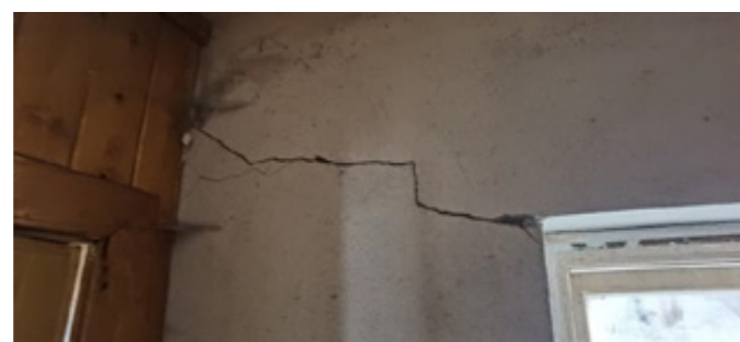
Sprekker i yttervegg
