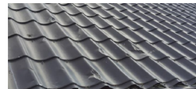
Skada takplater takfall vest
