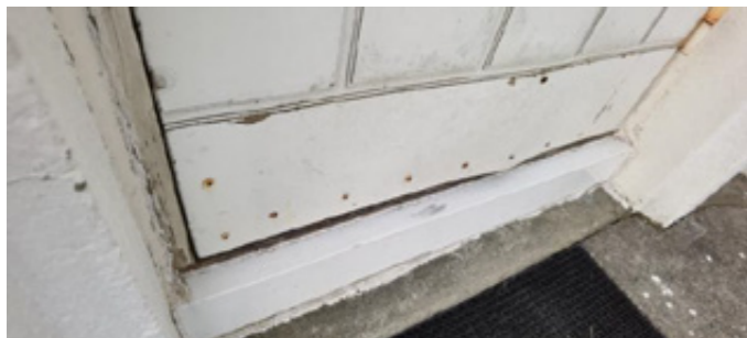
Fuktskada utside ytterdør 1. etasje
