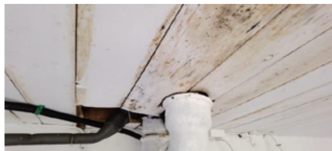
Roteskada himling/etasjeskille i kjeller
