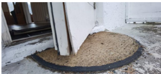
Fuktskada utside ytterdør 2. etasje
