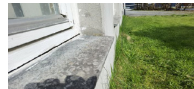
Opning mellom utvendig vassbrett av skifer og vindaug
