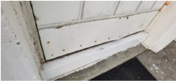
Fuktskada utside ytterdør 1. etasje
