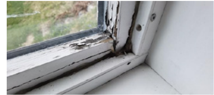
Skada innvendig vindaugskarm
