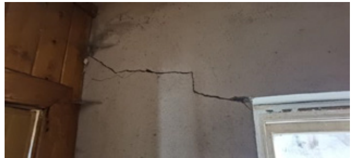
Sprekker i yttervegg
