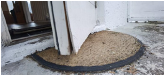
Fuktskada utside ytterdør 2. etasje
