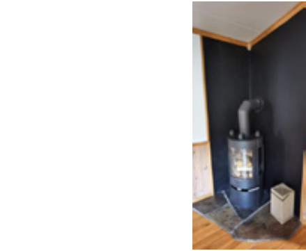
Vedovn i 1. etasje
