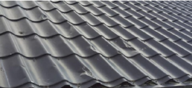
Skada takplater takfall vest
