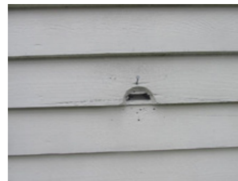
Hol i kledningsbord på austveggen.
