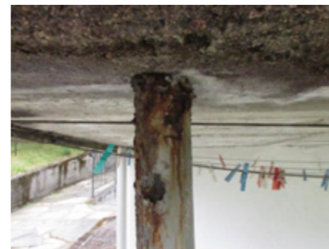
Rusta stålsøyler under balkongdekke.
