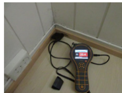
Fuktmåling i hjørnet mot søraust i kjellarstova.
