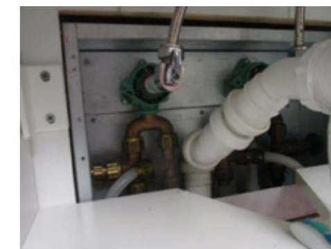
Rørsentral i badet.
