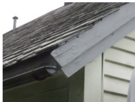
Sprekker og råteskade i nedre del av vindskier.
