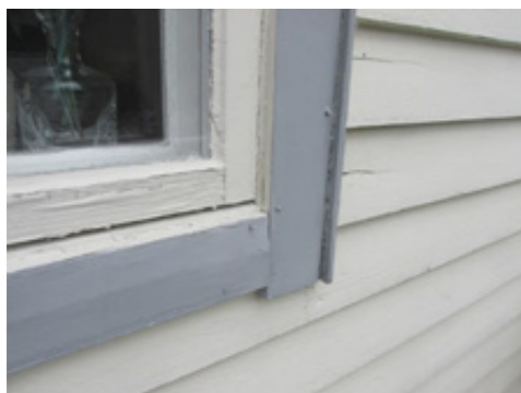
Eldre vindu uten vassbrett og med slitt overflatebehandling.
