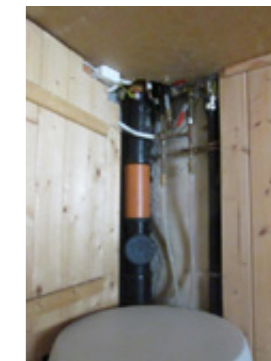
Røropplegg bak veggluke i bad/vaskekjellar
