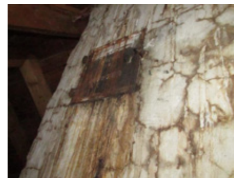
Riss i pussa overflater og rusta feieluke.
