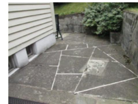
Forstøtningsmuren ved inngangspartiet manglar gjerde og har store sprekker.
