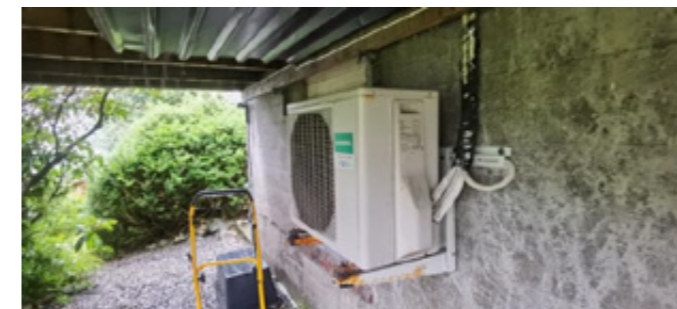
Utvendig del av varmepumpe
