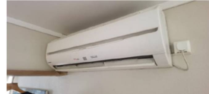
Innvendig del av varmepumpe
