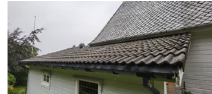
Takfall sør på tilbygg
