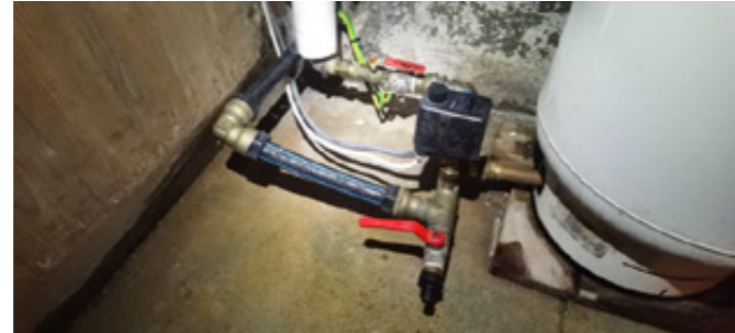
Hovudinntak med hovudstoppekrane
