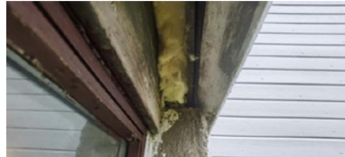
Overgang vegg/grunnmur over vindaugsopning i grunnmur.
