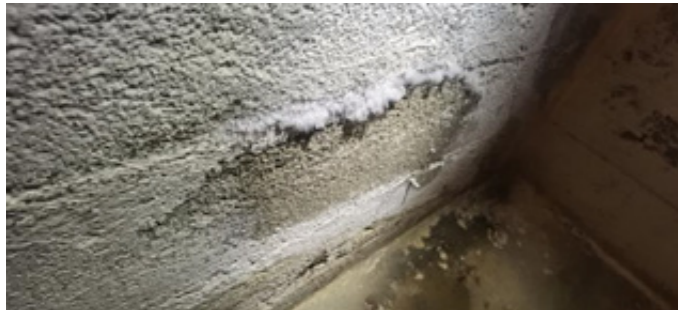
Saltutslag på grunnmur (symptom på fuktinntrenging)
