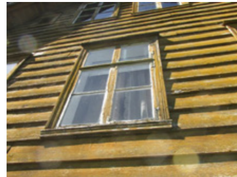
Eldre vindu er nedslitte og råteskada.
