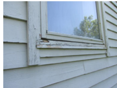
Vindua frå 1970-talet har fukt- og råteskade.
