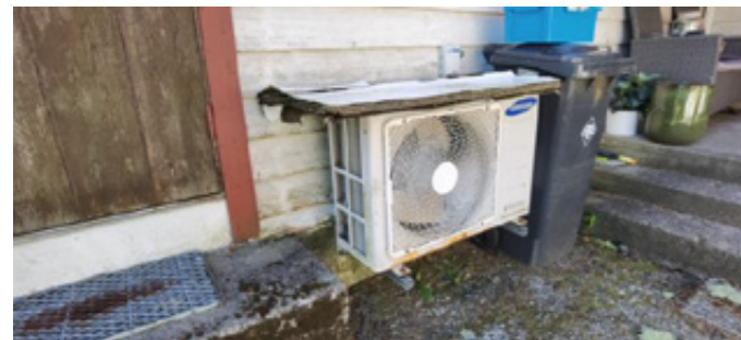
Utvendig del av varmepumpe
