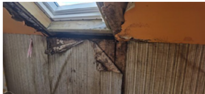
Innvendig skade etter fuktinntrenging
