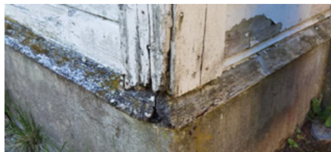
Roteskada utvendig kledning/veggfasade
