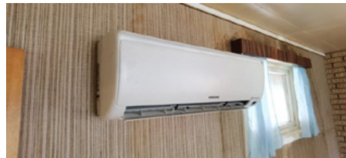
Innvendig del av varmepumpe
