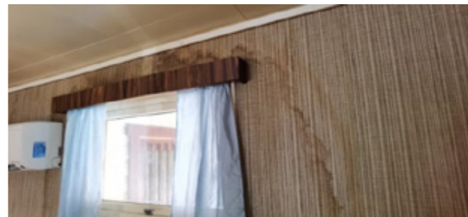
Innvendig skade etter fuktinntrenging
