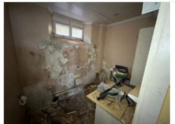
Fuktgjennomslag i underetasjen
