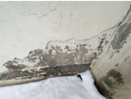
Murpuss som har løsnet.
