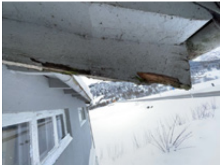
Råteskade på vindskibord.
