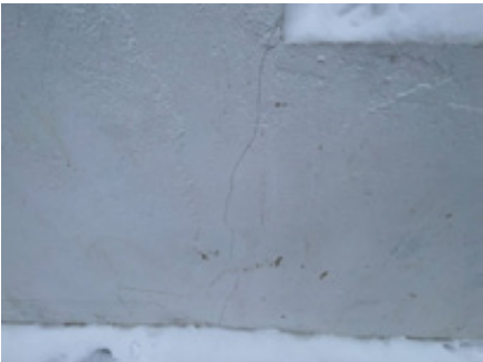
Sprekker i grunnmuren.
