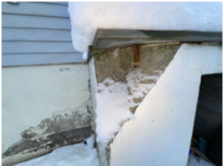
Bildet viser skader på trappekonstruksjonen.
