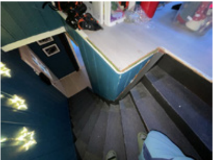
Bildet viser manglende rekkverk.
