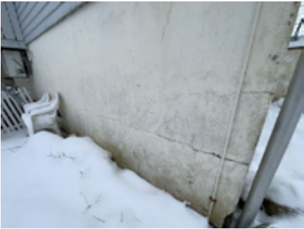
Sprekker i grunnmuren.
