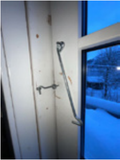
Midlertidig låsemekanisme på balkongdør i 2.etasje.
