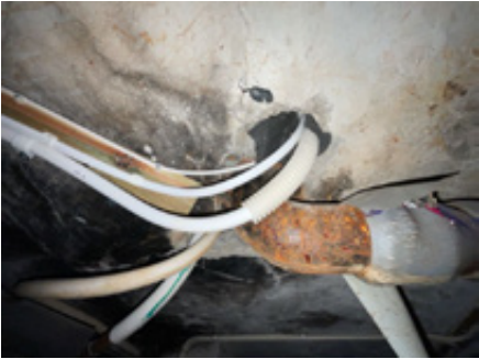
Avløpsrør av støpejern.
