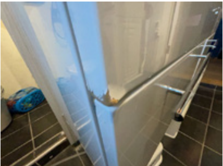
Skader på baderomsinnredning.
