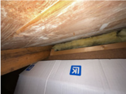
Bildet viser manglende ventilering i overgang isolasjon og undertak.
