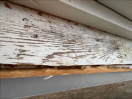
Slitasje på vindusforing og avvik i finish og utførelse.
