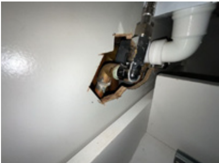
Manglende tetting rundt rørgjennomføring i vegg.
