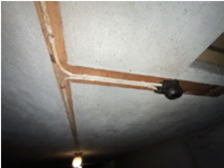
Bildet viser eldre el.anlegg i kjelleren.
