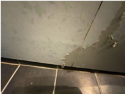
Fuktskader på baderomsplater.
