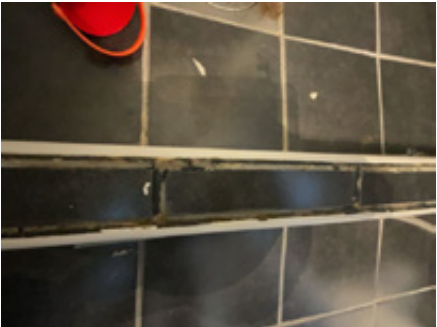
Bom/sprekker i flis og flisfuger.
