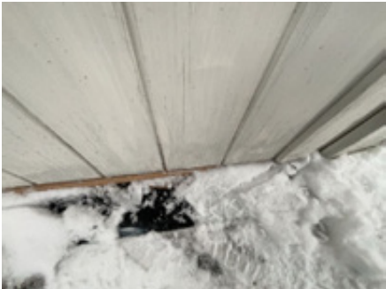
Malingslitasje på balkongdøren.
