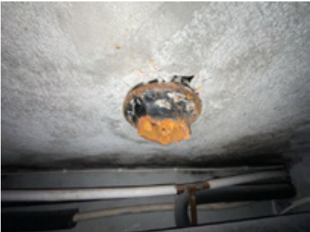
Avløpsrør av støpejern i etasjeskille av betong.
