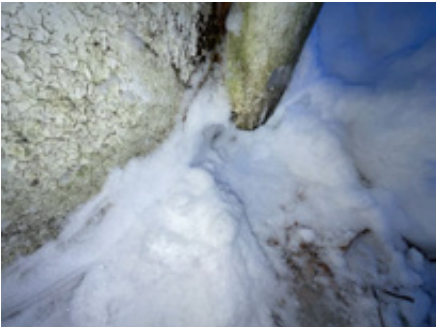
Nedløpsrør som ikke er koblet til rør i grunn.
