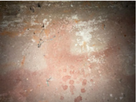
Saltutslag på kjellergulv.
