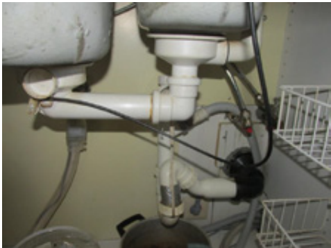
Utett kopling på avløpsrøret. ETASJE > KJØKKEN
