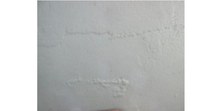
Flekkvise saltutslag/bobling i innvendig maling i boda på grunn av fukttransport gjennom murveggen.
