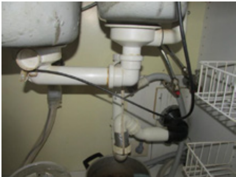
Utett kopling på avløpsrøret. ETASJE > KJØKKEN
