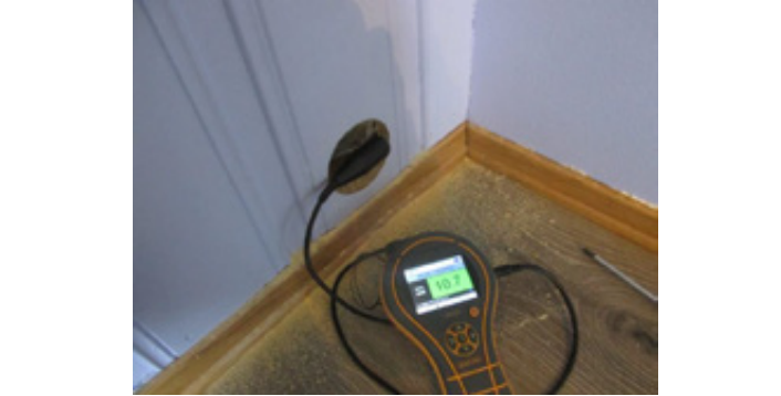
Fuktmåling i innvendig utfora vegg under terreng i stova i underetasjen.
