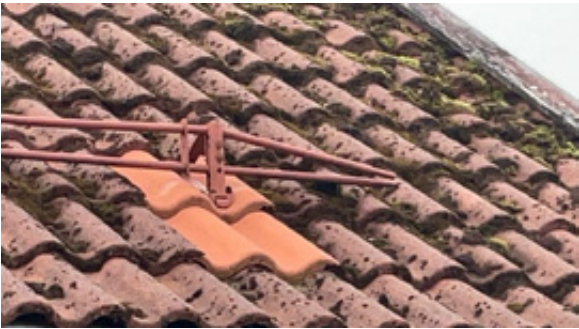
Bildet viser skade på snøfanger.
