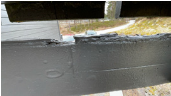
Råteskader på rekkverksbord.
